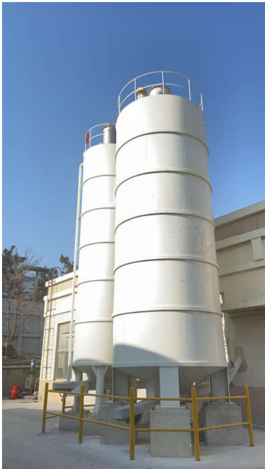
碳酸钙储存装置
